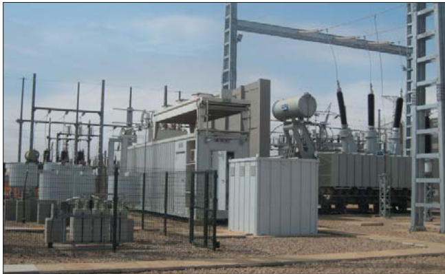
Установка УШРТ 60 МВА 220 кВ на ПС Viana (Ангола)
