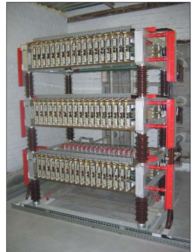
Тиристорный вентиль для СТК-35 с водяным охлаждением
